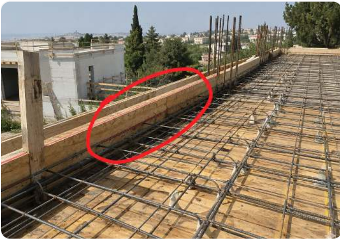
שפת המרפסת בדירה 20 - הברזל צמוד לדופן התבנית
